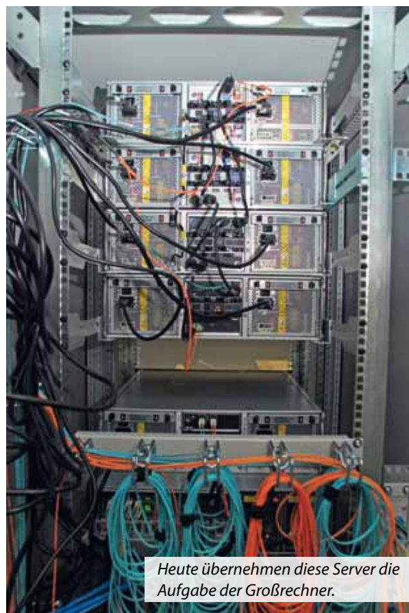
Einer von vier ehemaligen Großrechnern, inzwischen außer Betrieb.
